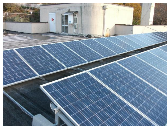
Figura 4.15 - Vista dell'impianto fotovoltaico
