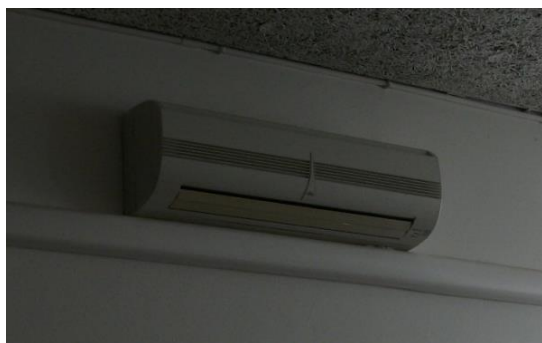
Figura 4.12 - Particolare di uno dei monosplit interni
