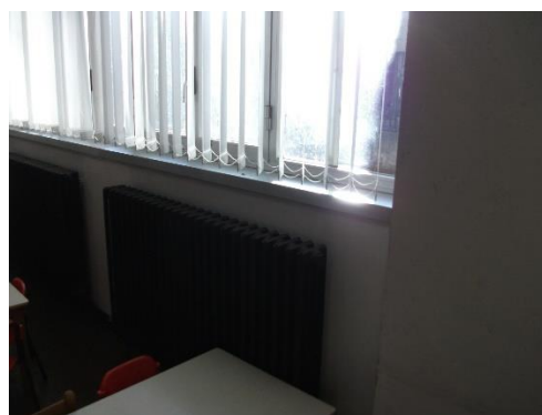
Figura 4.6 - Particolare dei radiatori in ghisa
