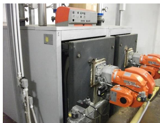
Figura 8.6- Particolare del generatore di calore attualmente installato
