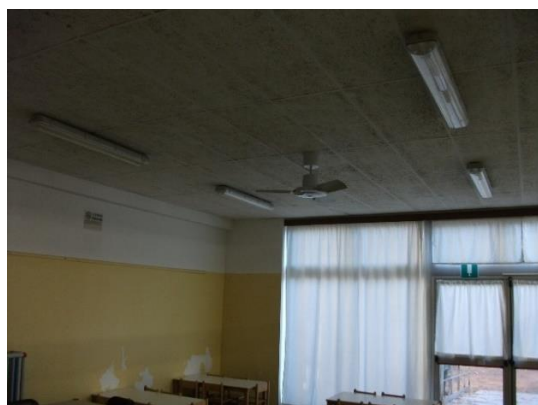
Figura 4.13 - Particolare dei corpi illuminanti installati a soffitto
