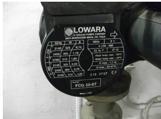
Figura 8.9– Particolare delle pompe di circolazione
