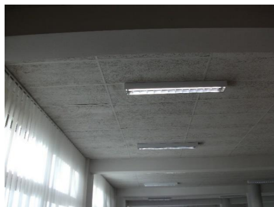
Figura 4.14 - Particolare dei corpi illuminanti ubicati nel refettorio
