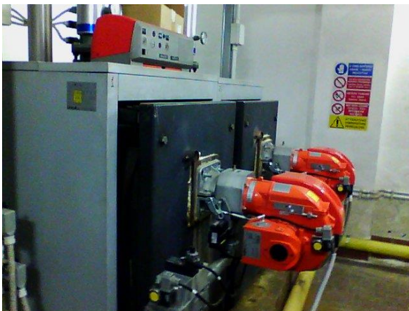
Figura 4.10 - Particolare delle caldaie a basamento
