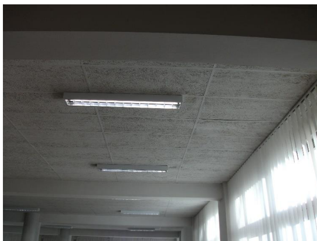
Figura 8.11- Particolare dei corpi illuminanti attualmente installati
