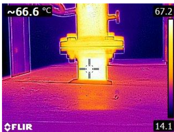
Figura 4.8 – Indagini diagnostiche circuito di MANDATA
